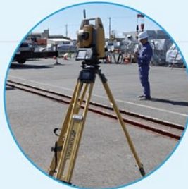
TSの遠隔操作
